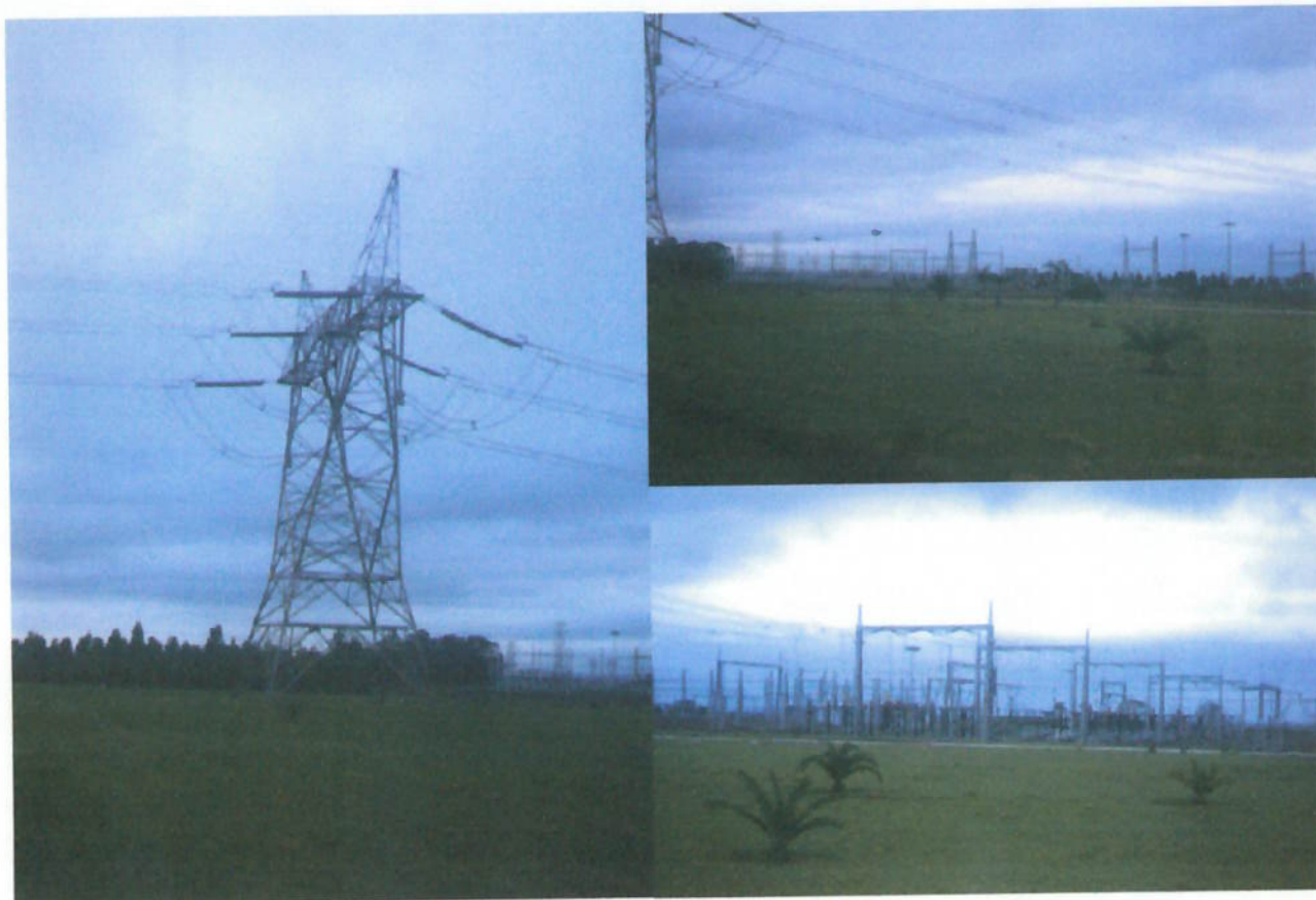
Figura 2.1.9 – Subestação da Cidade de Assis
