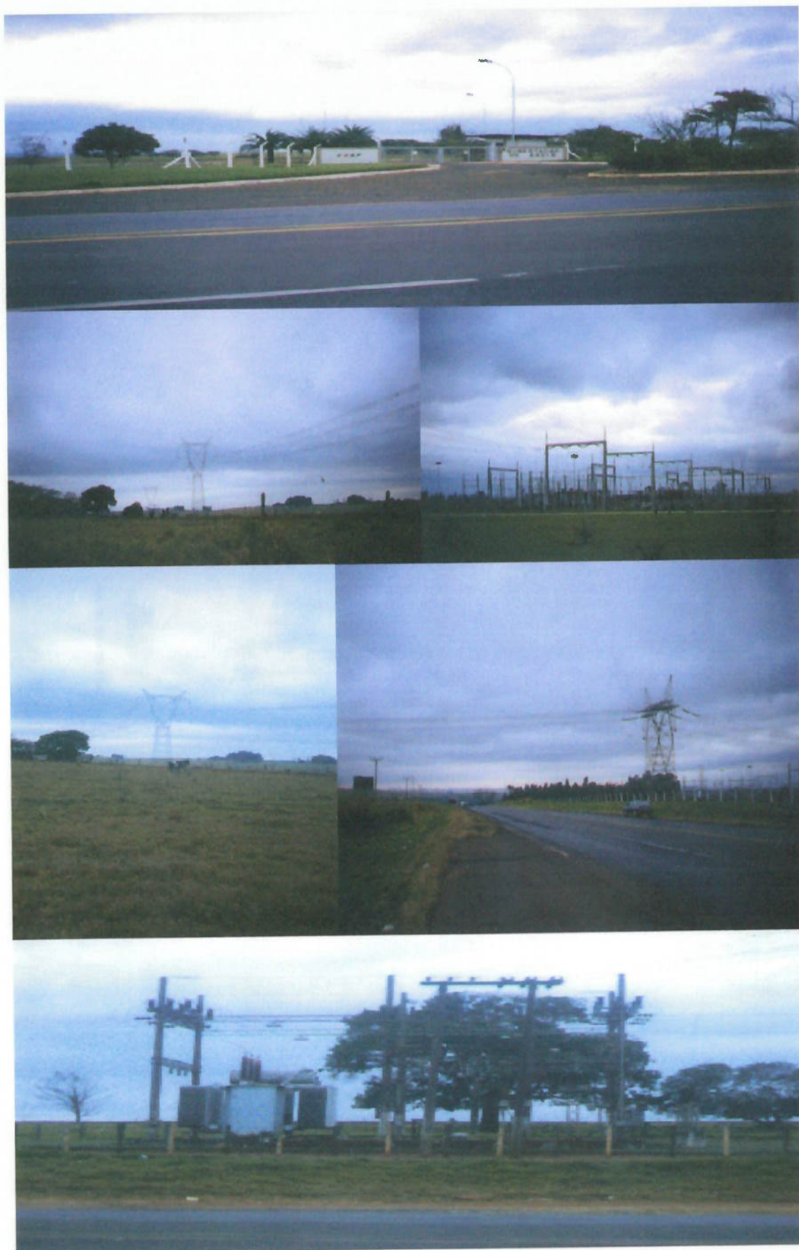
Figura 2.1.10 – Subestação da Cidade de Assis e as Subestações de Beira de Estrada Escola Politécnica da Universidade de São Paulo Departamento de Engenharia de Energia e Automação Elétricas
